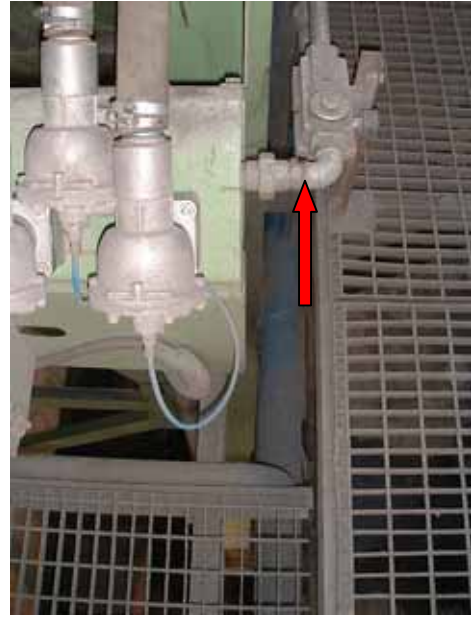
图 8. 进气管口径太小，造成补气不足
