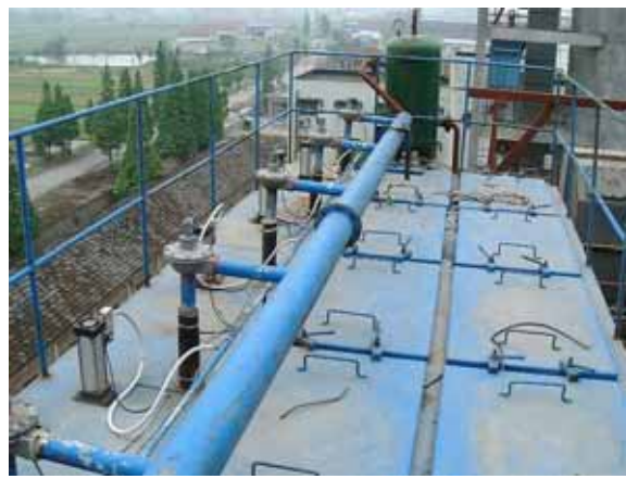
图 4. 压缩气没有采用冷冻干燥或任何处理措施，含有大量的油水和杂质。气包和贮压罐之间没有三联件，不符合规格的压缩气气源直接输入脉冲阀。
