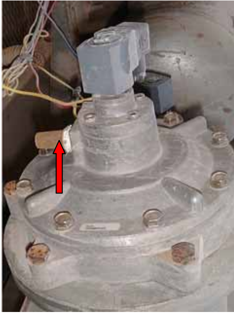
图 7. 阀门大出气口上有消音器，其网孔被粉尘堵塞
